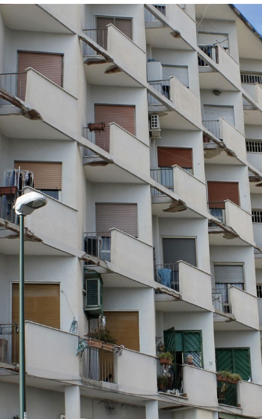
Fig.4 - Particolare dei balconi ruotati a 45° in uno dei 'palazzi ponte' ad Agnano, con evidenti segni di degrado (foto di Carolina De Falco)
